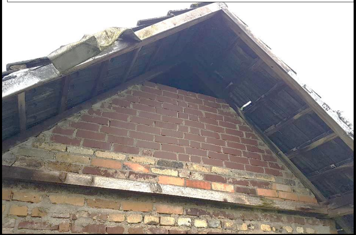
Schuppen im B-Plangebiet – keine geeigneten Spalten im Gemäuer, Dachpfannen liegen ohne Verkleidung auf -> keine Spalten. Als Fledermausquartier ungeeignet.
