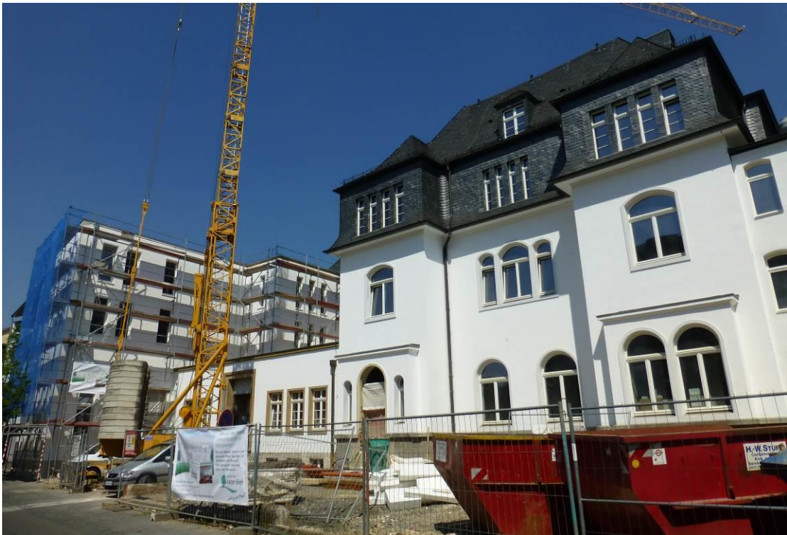
Abbildung 33: Sanierung, Umbau und Erweiterung des ehemaligen Tagungszentrums zum „Kaiser Palais“. Foto: Stadt Königswinter.
